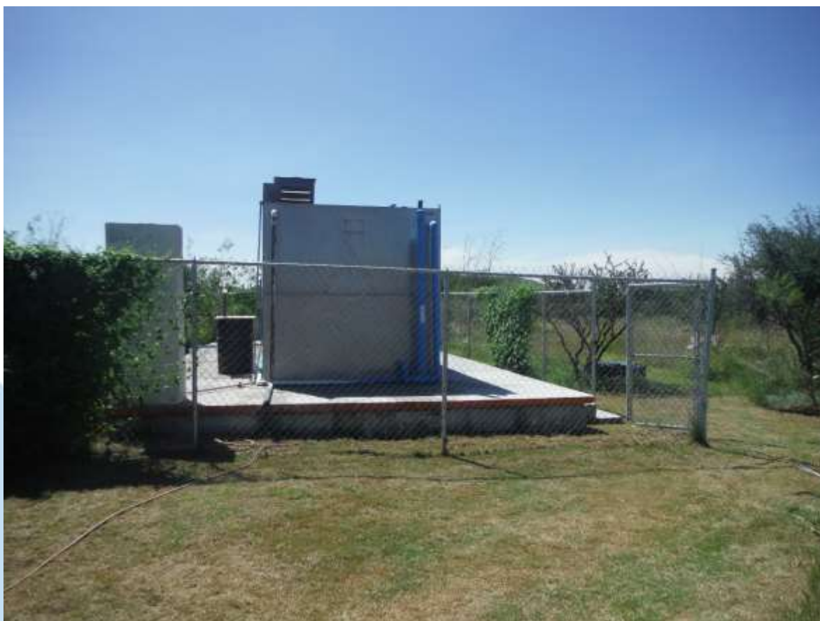
Fotografía: Planta Tratadora de Aguas Residuales
